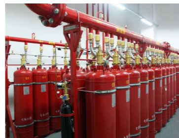
气体消防系统
