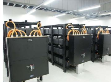
UPS 电池系统
